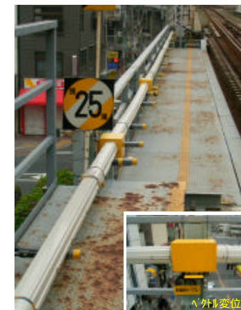
鉄道高架橋への適用事例 (ベクトル変位計 水平変位)
