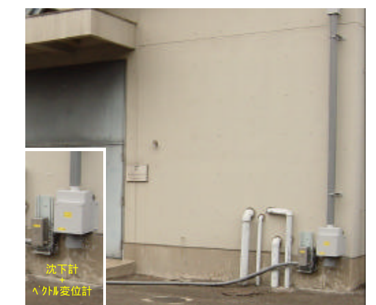
建築物への適用 (沈下計 + ベクトル変位計 傾斜角)
