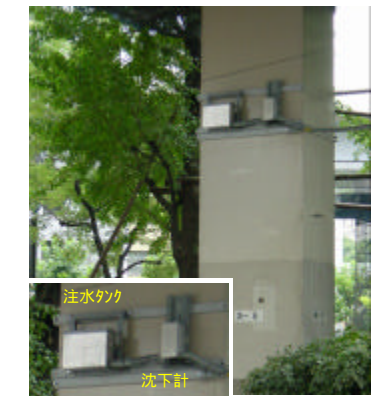
首都高橋脚への適用事例 (沈下計)
