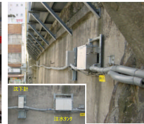
鉄道擁壁部への適用事例 (沈下計)
