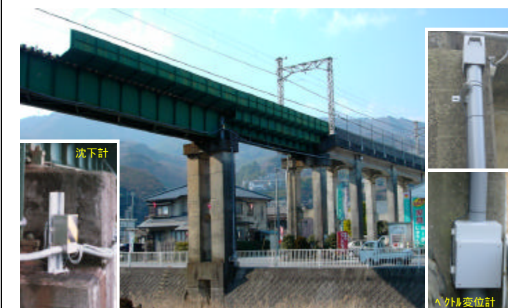
鉄道高架橋への適用事例 (沈下計 + ベクトル変位計 傾斜角)
